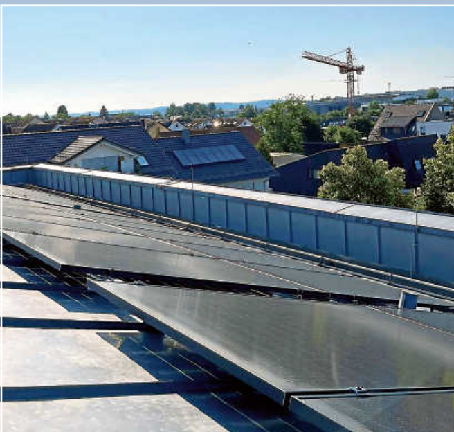
Die PV-Anlage auf dem Rathaus ist bereits in Betrieb.
